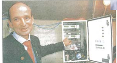
Im Satellitenschrank im Serviceschacht registrieren Messinstrumente kleinste Veränderungen im Boden-Wasserhaushalt der Lysimeter, erläutert Georg von Unold.
